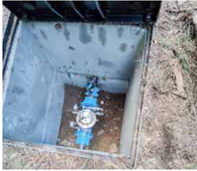
Die Trinkwasserversorgung für Tisens wurde optimiert.
